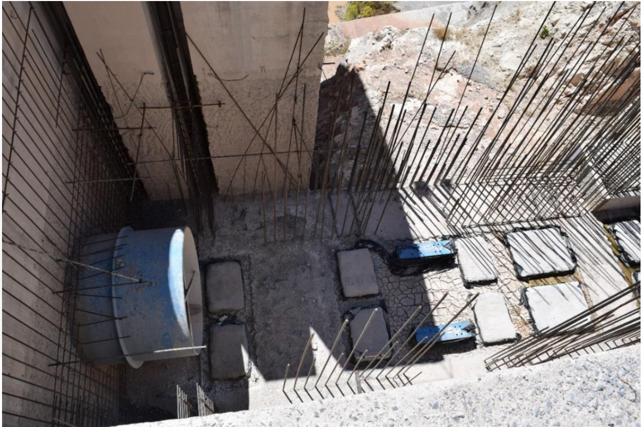
Foto 5. Fundación de toma N°2 y tubería embutida en el hormigón de la presa
