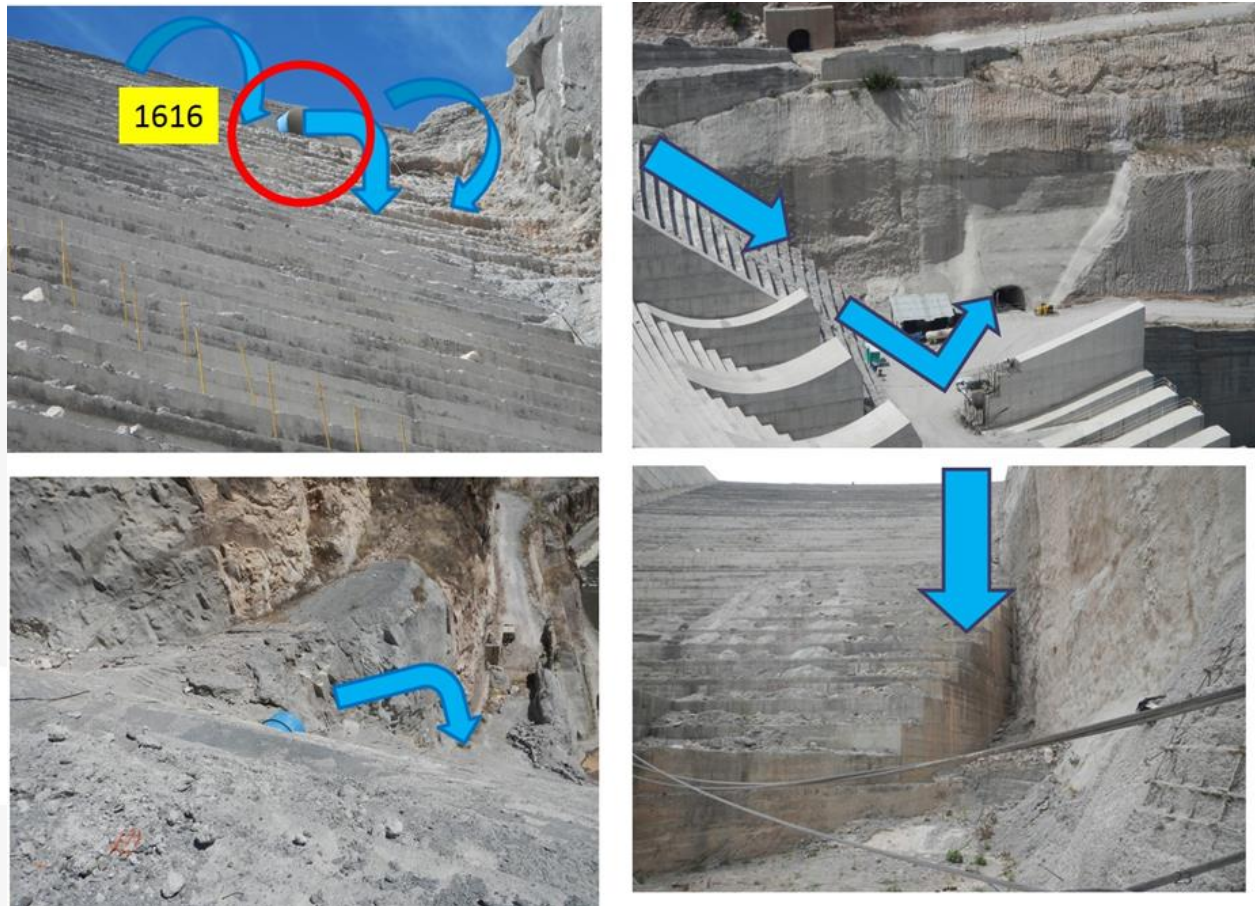
Figura 11. Trayectoria del agua en margen izquierda durante un sobrepaso
