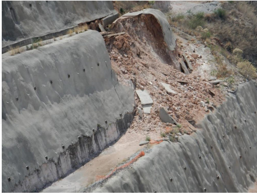
Foto 14. Deslizamiento confortación M. Derecha
