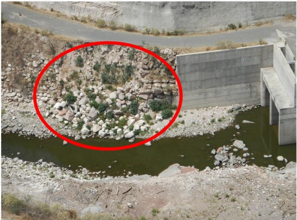
Foto 10. Deslizamiento en la embocadura
