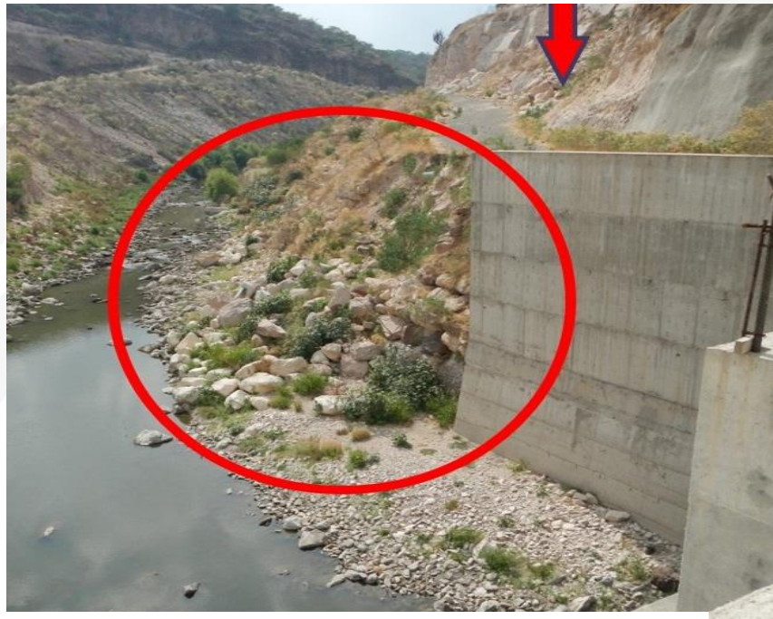
Foto 17. Deslizamientos del talud en Margen Izquierda
