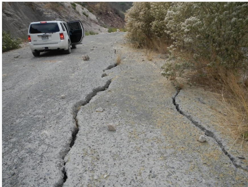
Foto 15. Inestabilidad en caminos de acceso margen derecha
